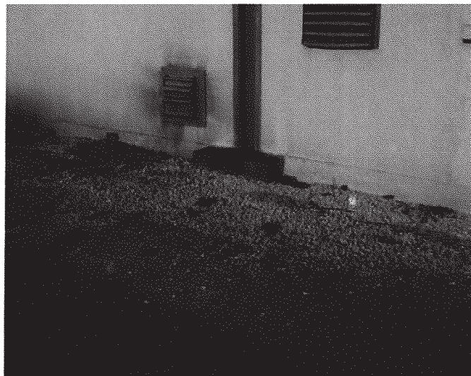
Extérieur de l'ancien local de stockage d'huiles (vue vers le mur extérieur du local)
